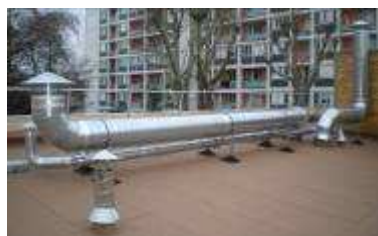
Gaine de ventilation en toiture
