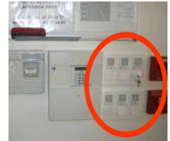
Commande d'éclairage du secrétariat
