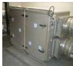
Local de l'échangeur thermique
